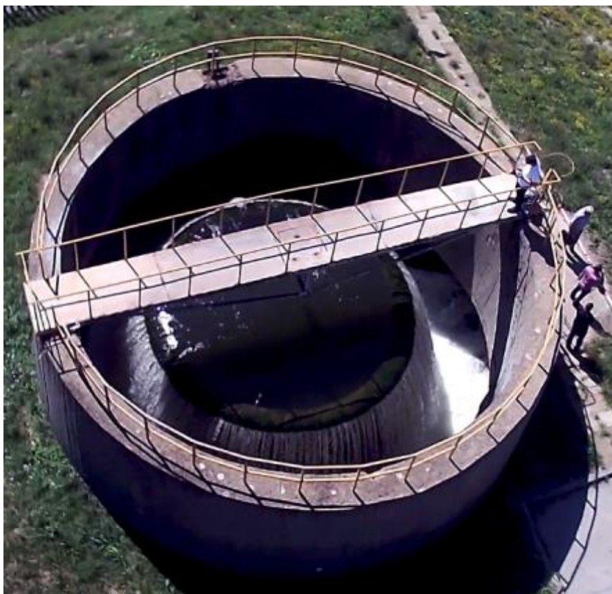
Slika 1-9 Preljevni bunar rashladne vode
