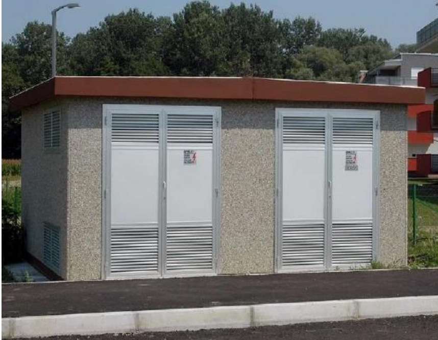
Slika 1-5 Primjer trafo stanice tipa TS DTS 12 (24) 2×1000 s kosim krovom
