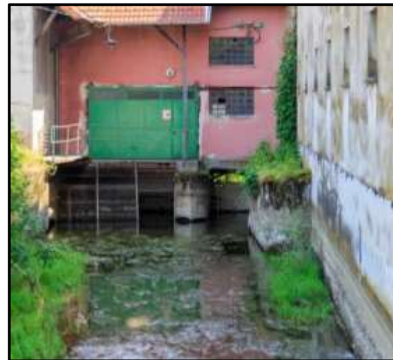
Slika 2-7 Kraj gornjeg derivacijskog kanala neposredno prije postojeće devastirane strojarnice
