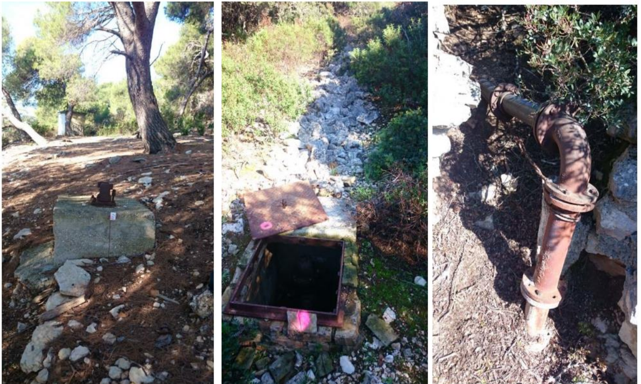
Slika 12. Trasa između čvora M7 i M8; trasa kod čvora M12; cjevovod izvan zemlje čv.M13
