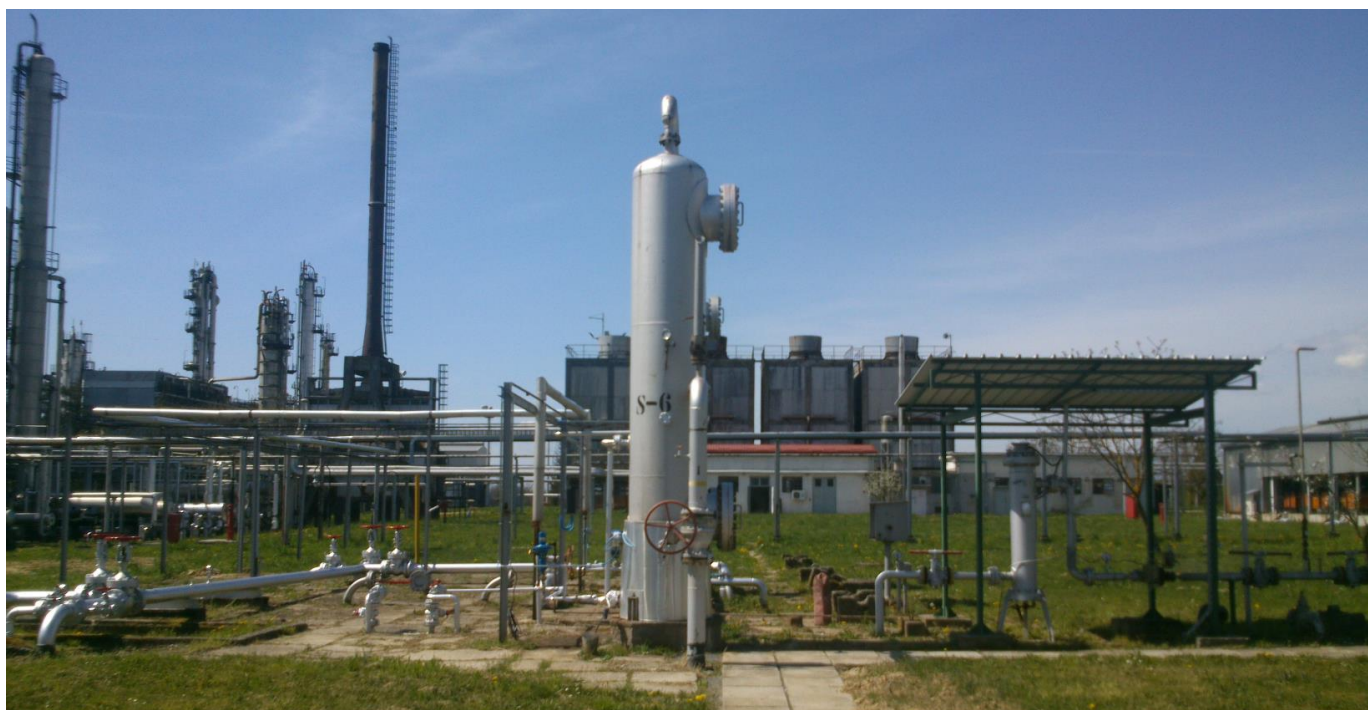
Sl.2.1-11: Redukcijska stanica
