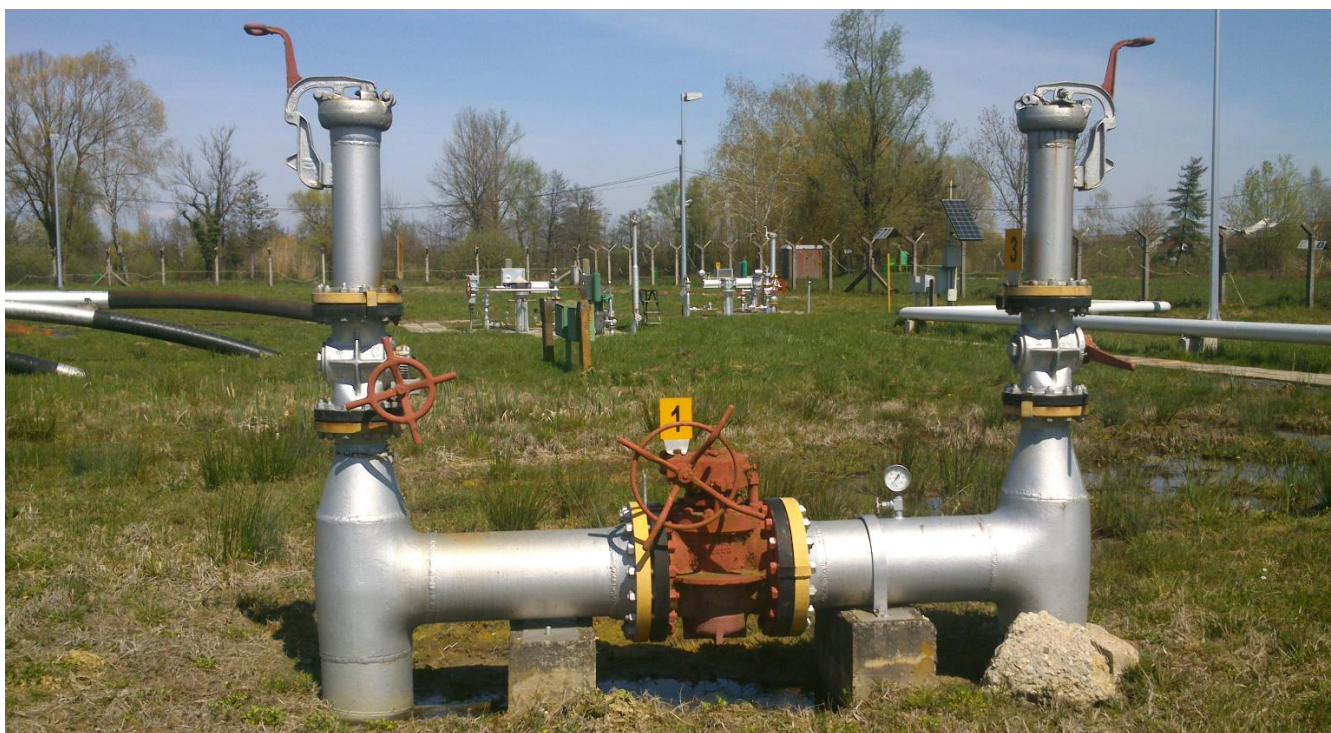
Sl. 2.1-6: Blokadno ispušna stanica na DN 350
