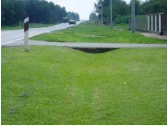
Slika 19. Otvoreni cestovni kanali u Čemincu
