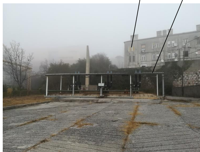
Podzemni spremnici UNP-a, zaštitni zid i stambena zgrada iza lokacije postrojenja
