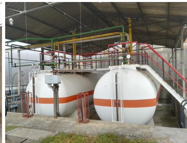
Nadzemni spremnici UNP_a
