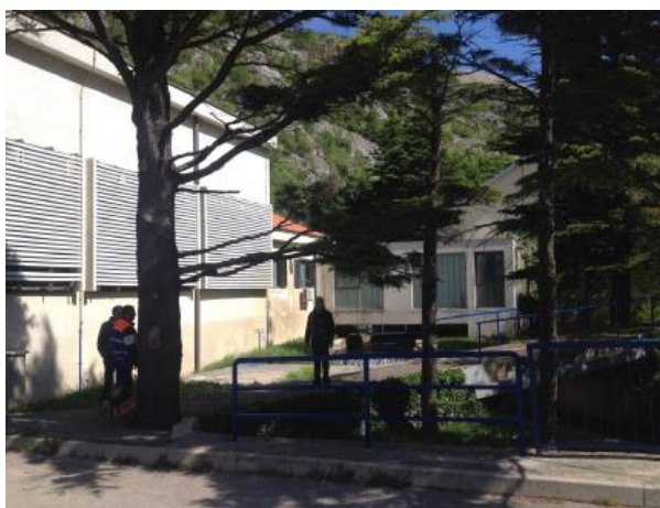
Pogled na strojarnicu i toplu vezu prema starom dijelu zgrade (u podnožju fasade strojarnice – glavno sabirno okno)
