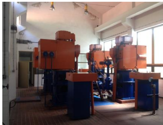
Strojarnica u CS Žrnovnica
