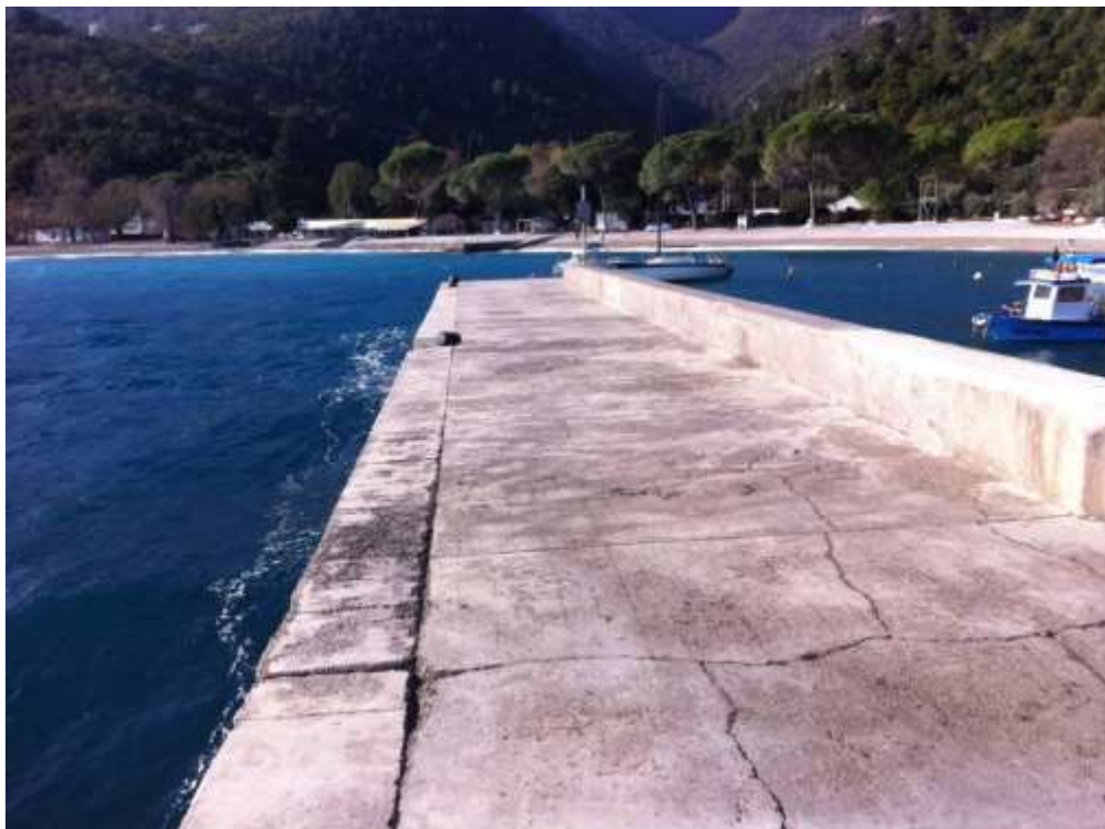
Pogled na postojeći lukobran sa oštećenjima
