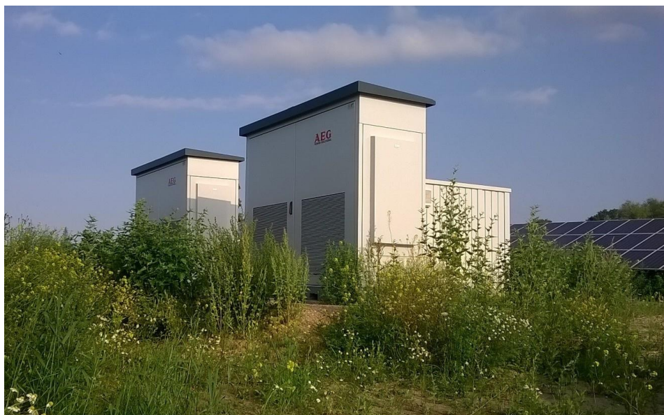
Slika 8. Primjer postavljenog centralnog izmjenjivača; Izvor: https://mms.businesswire.com/media/20150129005488/en/451005/5/AEG_Power_Solutions_PV_Care_Check.jpg
