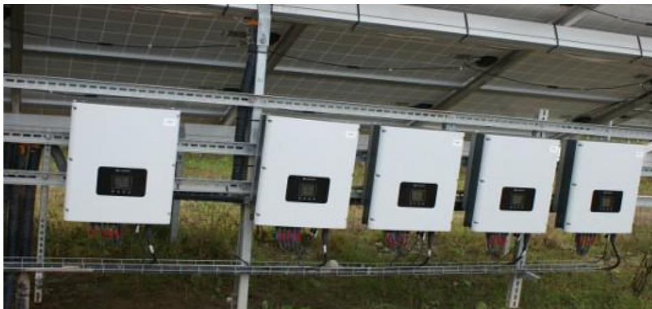
Slika 7. Primjer izmjenjivačkog sustava uz nosač metalne konstrukcije; Izvor: https://www.eqmagpro.com/huawei-string-inverters-increasingly-sought-in-the-indian-market/
