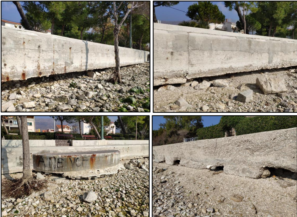
Slika 2.1-2. Podlokana obala na predmetnoj obalnoj dionici u Kaštel Kambelovcu (izvor: Bertolino inženjering d.o.o., 2019.)
