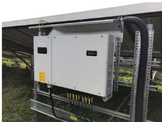
Slika 2.3-4. Primjer montaže izmjenjivača niza (Idejno rješenje, rujan 2020)
