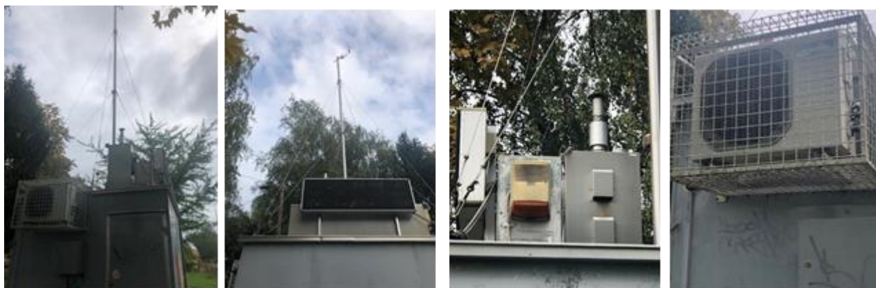
Sl. 2.1-4: Vanjska oprema za demontažu na mjernoj postaji Sisak - 2 Galdovo
