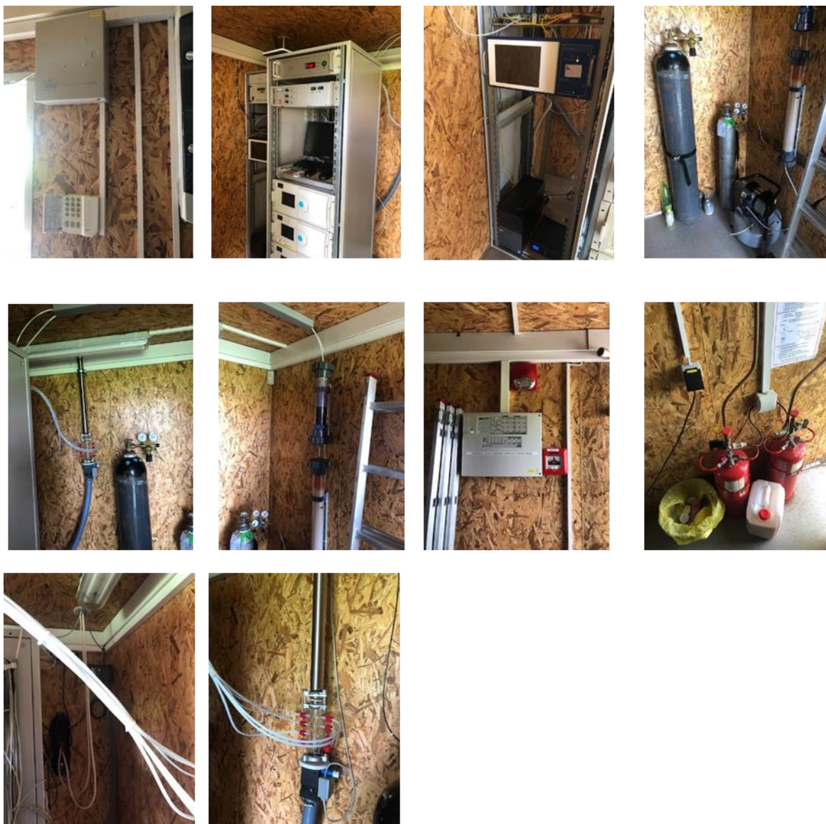
Sl. 2.1-5: Unutarnja oprema za demontažu na mjernoj postaji Sisak - 2 Galdovo
