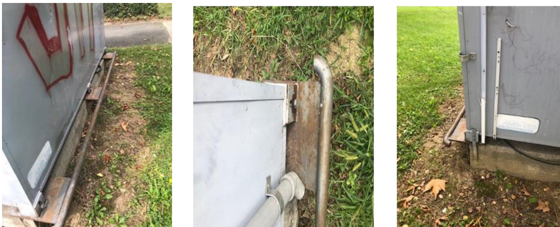
Sl. 2.1-6: Prikaz kontejnera na betonskom temelju
