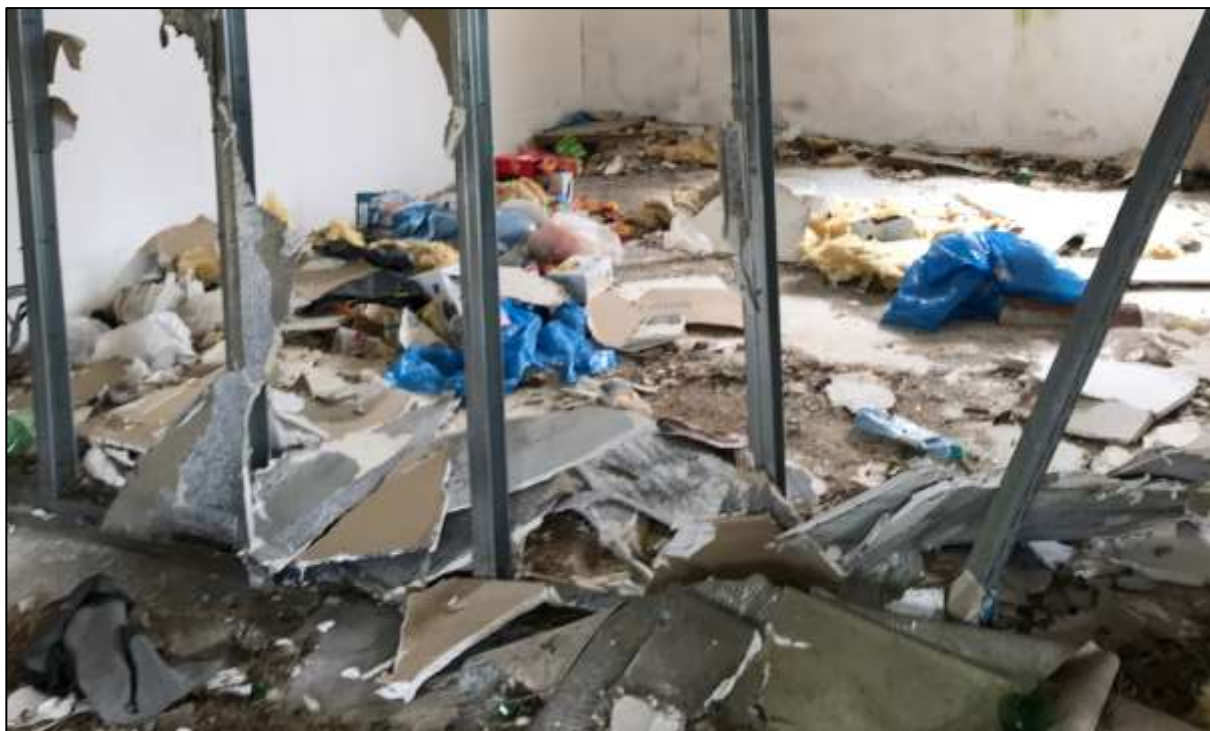
Slika 2.2.2.2-2 odbačen raznoliki otpad, situacija unutar objekta 1.
