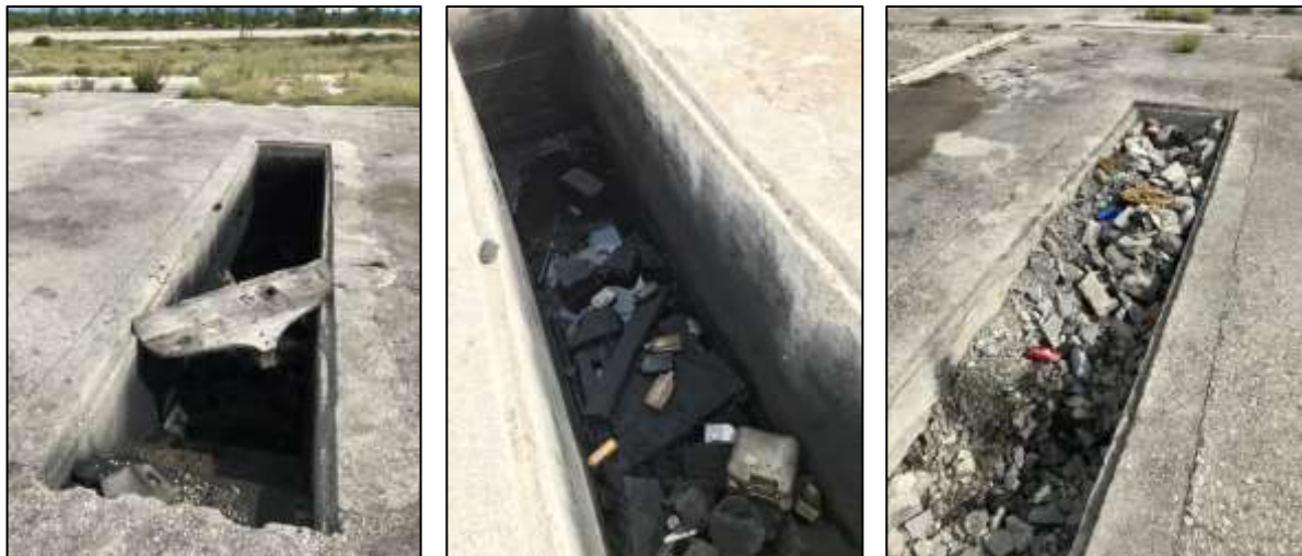
Slika 2.1.-11. LOKACIJA 8. Na ranije prikazanom platou (vidi lokacija 6.) s njegove krajnje istočne strane nalaze se tri betonske jame. Radi se o ostacima automehaničarskih jama za popravak vozila. U jamama su vidljivi ostaci tekućeg i krutog otpada.
