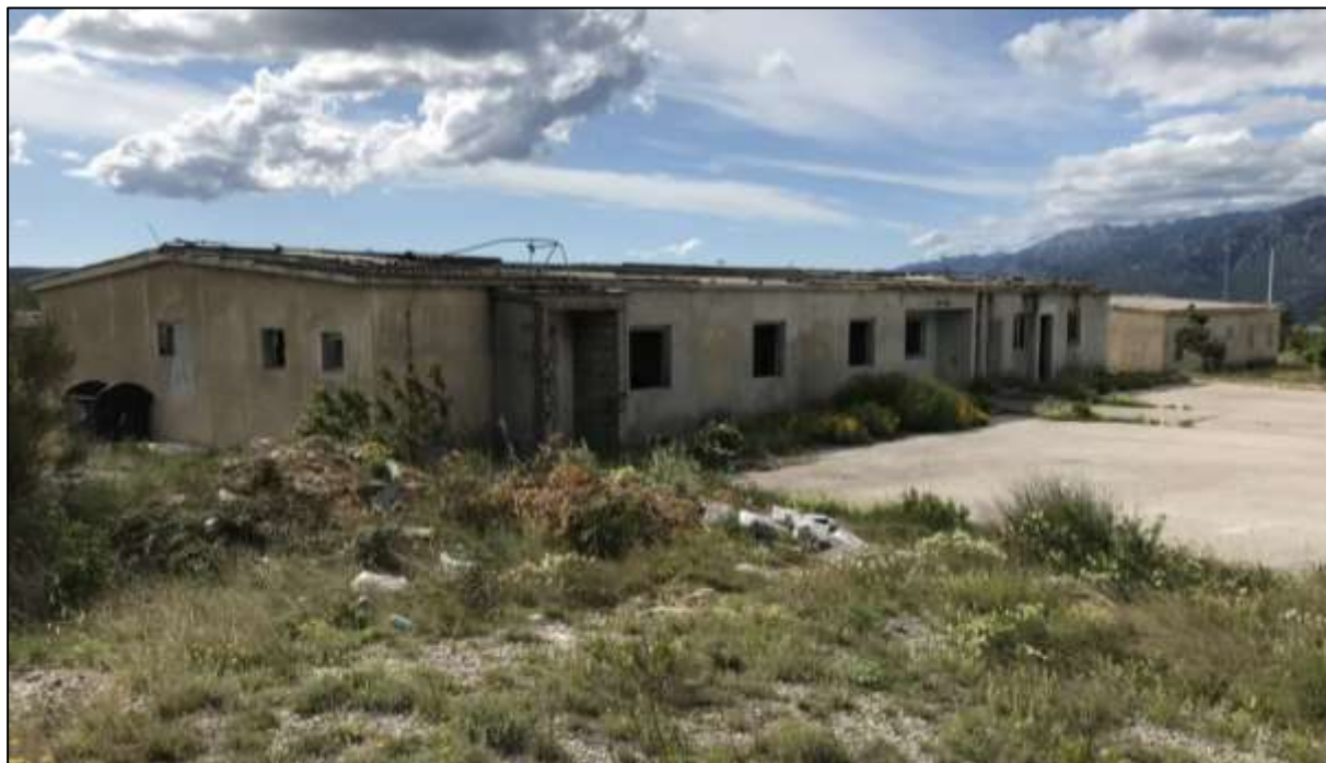
Slika 2.1.-5. LOKACIJA 2. Objekt 1 s parkirališnom površinom ispred te objektom 2 vidljivim u pozadini s desne strane
