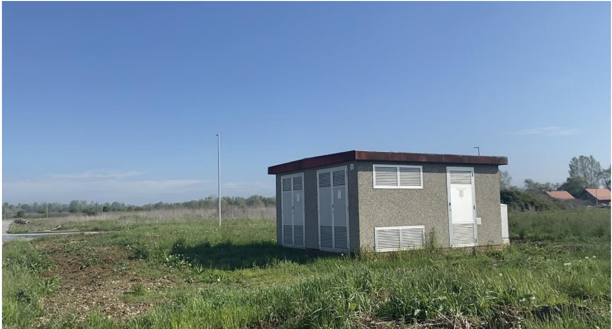
Slika 1.8 Trafostanica za prihvat električne energije
