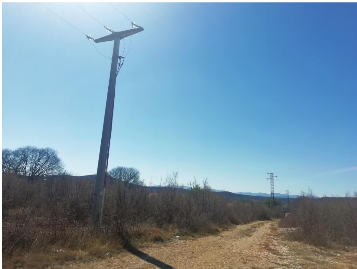
Slika 39. Dalekovod uz prilazni put transformatorskoj stanici TS 35/10 kV Unešić
