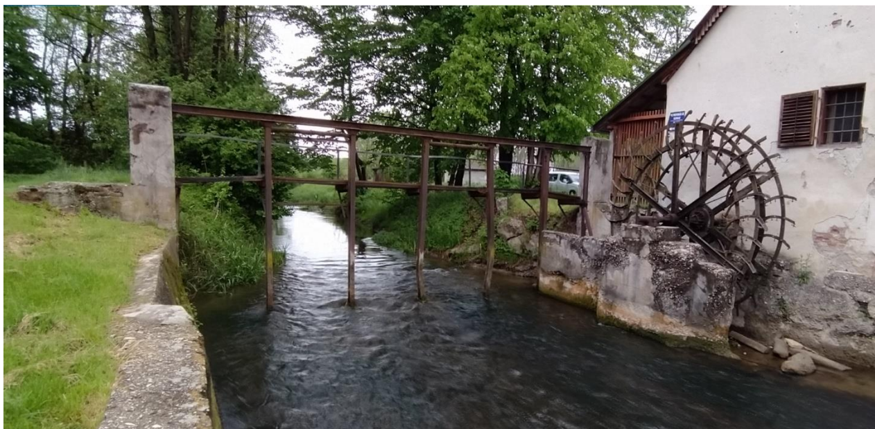
Slika 2.2-1 Postojeće stanje (oštećena konstrukcija ustave i vodno kolo)
