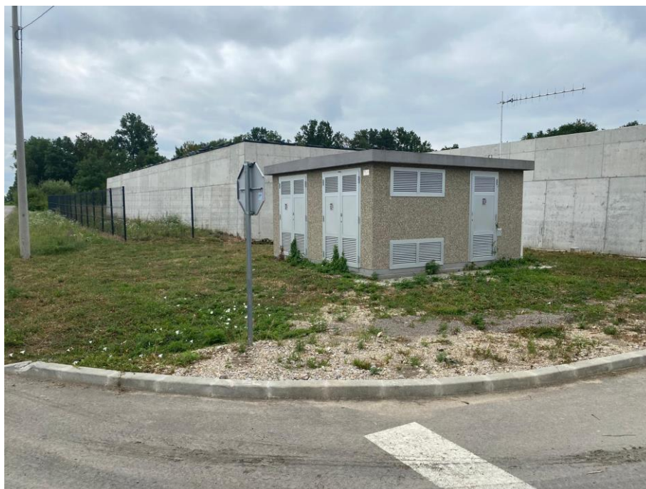
Slika 1.12 Trafostanica na koju će se vezati elektrana
