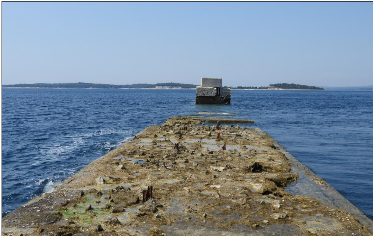
Slika 3. Značajnija oštećenja lukobrana luke Pula prema glavi lukobrana
