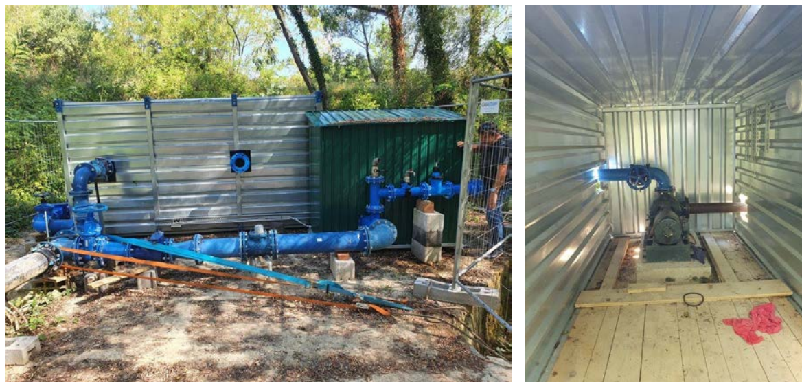
Slika 7. Montažno crpno postrojenje na izvoru Sv.Anton kapaciteta 30 L/s
