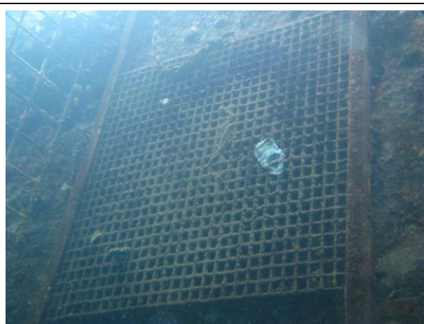
Sl. 2.2-14: Usis rashladne vode na dubini od 1 m, uzidan u betoniziranu obalu. Usis je ograđen rešetkom većeg oka 100x100mm, a sam ulaz u cijev je zaštićen rešetkom manjeg oka 20x20mm
