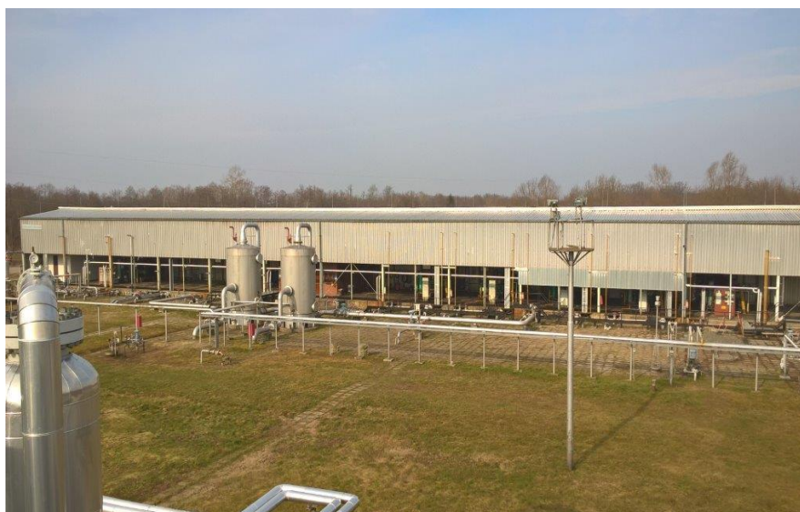
Slika 1.5.6. Kompresorska stanica Žutica
