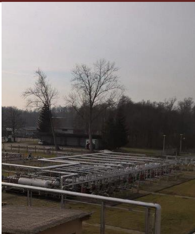
Slika 1.5.5. Centralna plinska stanica Žutica
